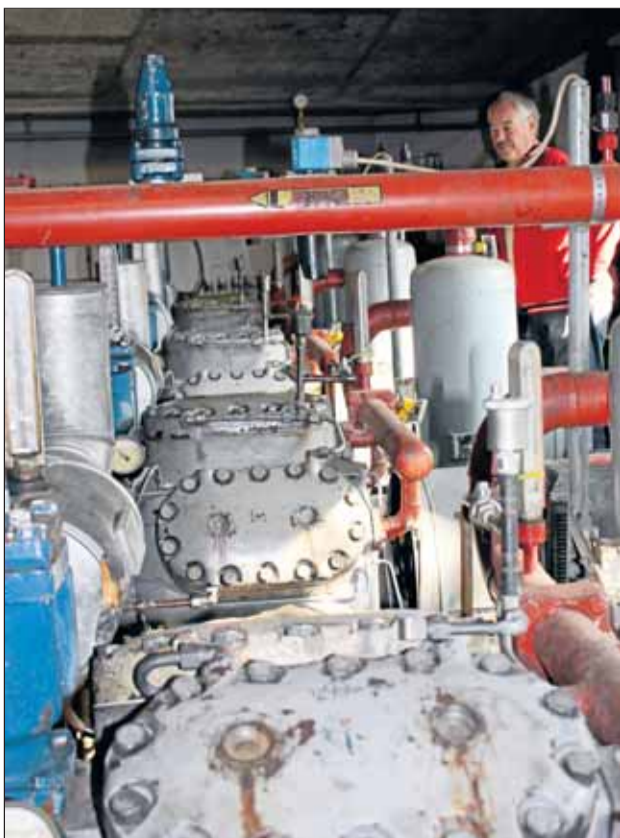
Uwe Bartels in der Kälteanlage des Eisstadions, Mitte Mai nimmt der TÜV die Technik unter die Lupe. Foto: Beckmann
